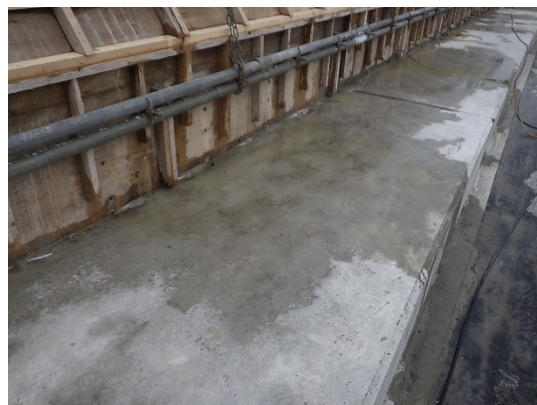
写真-5 型枠外へ排出された余剰水
