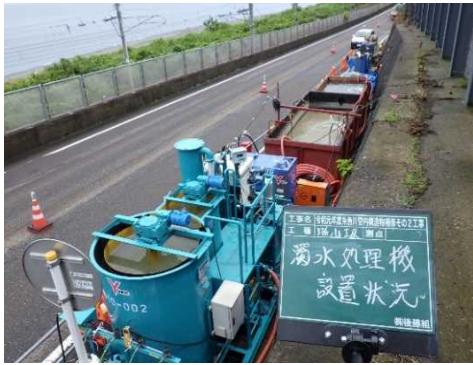
写真-10 濁水処理施設
