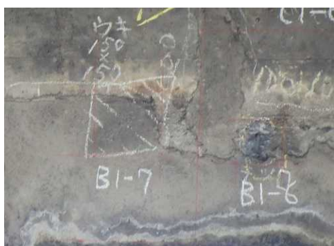
コンクリートの劣化
