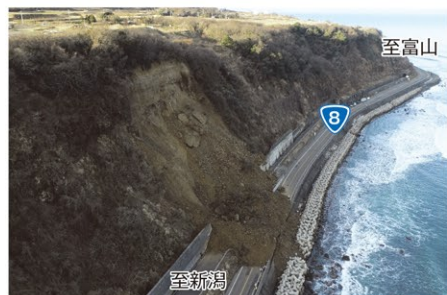
令和6年1月被災状況
