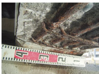
主桁の損傷状況(境橋)
