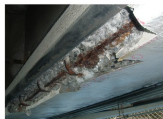
主桁の損傷状況（青海川橋）
