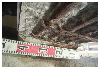
内部鉄筋の腐食状況(断面欠損)(境橋)
