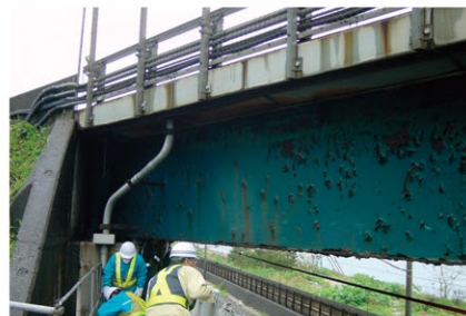
橋桁の発錆状況(青海跨線橋)
