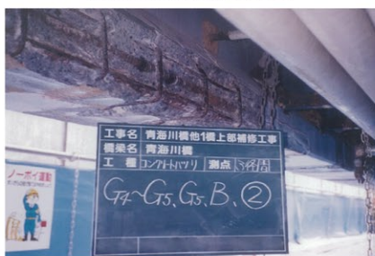
内部鉄筋(PC鋼材)の破損状況(断面欠損)(青海川橋)
