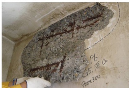
主桁の損傷状況(弁天大橋)
