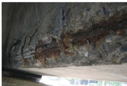
主桁の損傷状況(歌高架橋)
