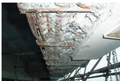
内部鉄筋(PC鋼材)の腐食状況(有間川橋)
