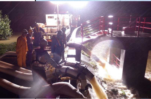
③正善寺排水樋管排水状況（上越市からの要請）
