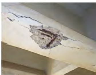
主桁の損傷状況(有間川橋)
