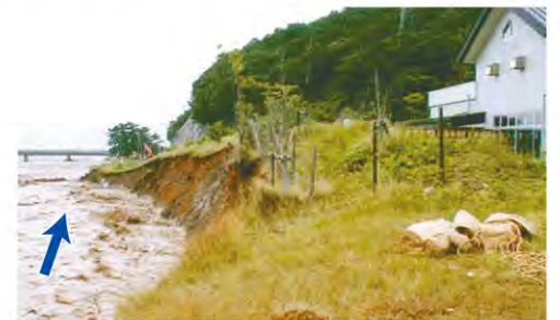
平成7年7月 姫川出水 糸魚川市大野地先 堤防欠損状況
