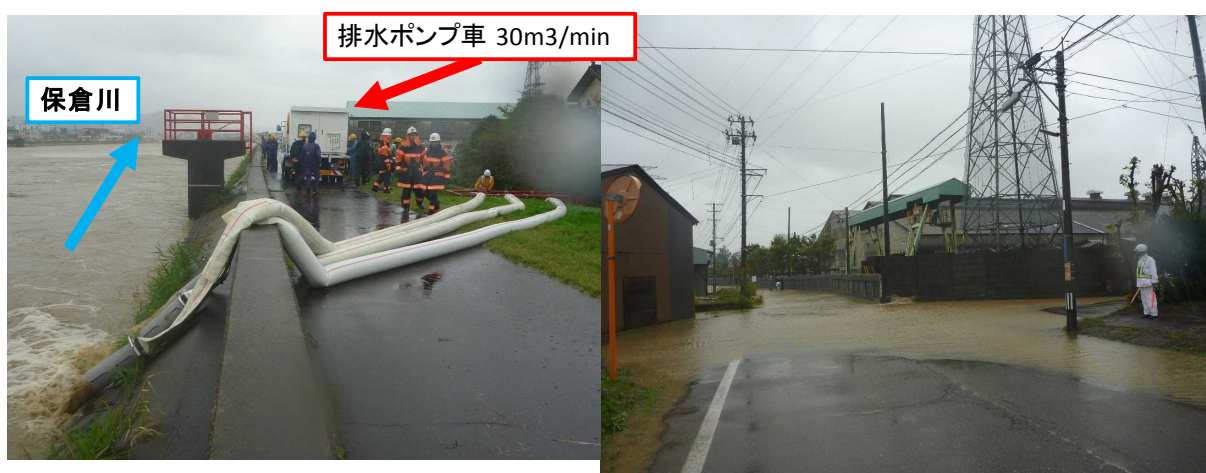
港町地先 港町第五樋門 排水状況 平成29年10月23日 10:00 浸水30cm程度
