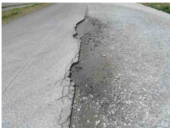
堤防天端舗装の段差状況写真(姫川)
