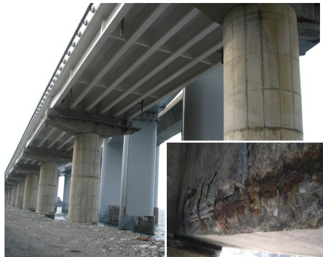
撤去するPC桁（H20撮影）と主な損傷状況
