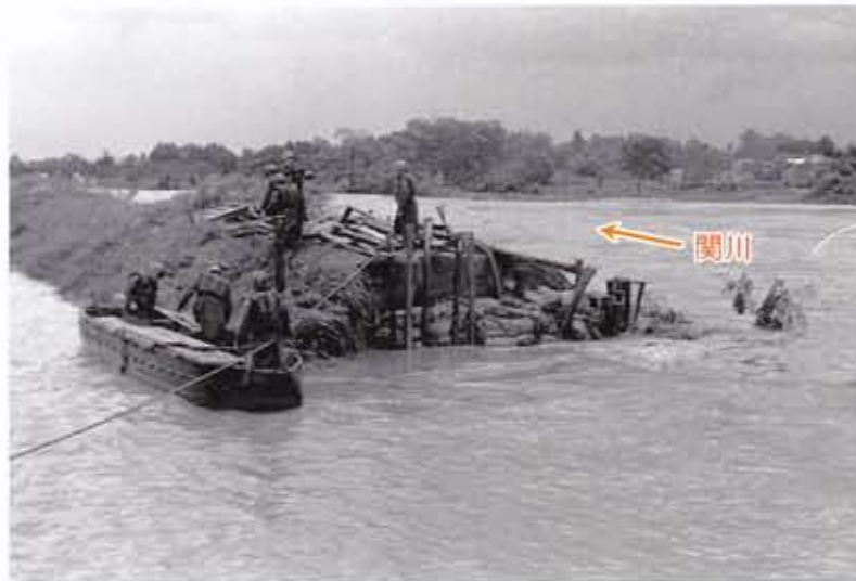
関川 中央橋下流左岸の堤防が決壊 濁流が流れ出し、高田市街地は大きな被害を受けました。
