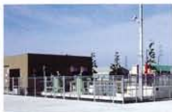
春日新田排水機場(上越市春日新田)
