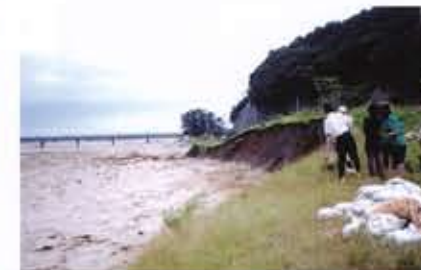
侵食被害状況（糸魚川市大野）
