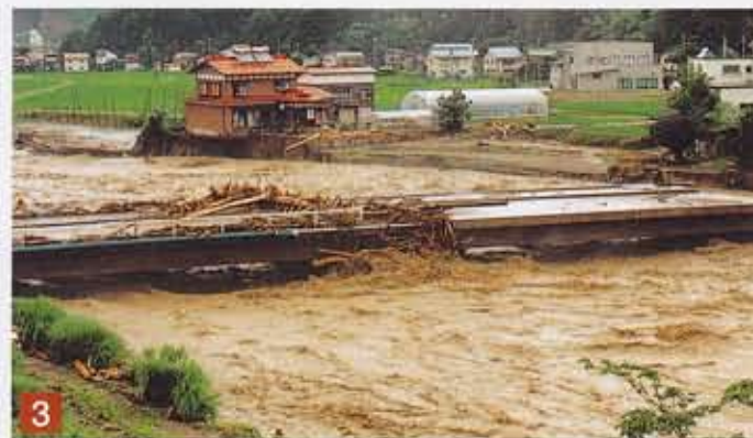
流木がからみついた学校橋（妙高市＜旧新井市＞除戸）
