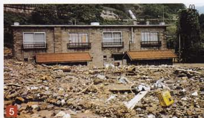
土石流によって1階部分が埋まった住宅（小谷村光明下）
