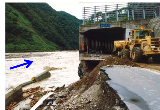
国道148号 唐沢洞門 被害状況
