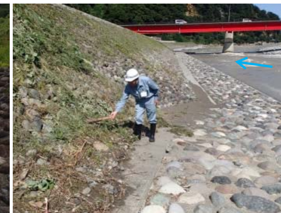
【出水後（姫川左岸 山本地区）】
