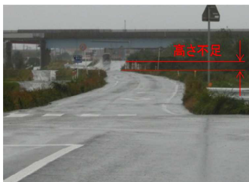
図 3-10 暫定堤防（高さ不足）区間 （2.6k 今井橋左岸付近）
