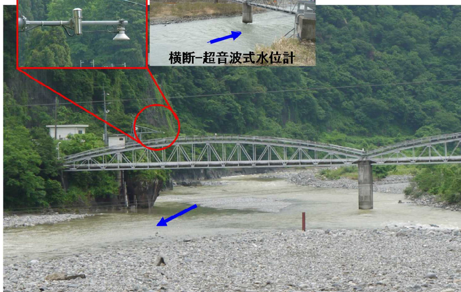
図 3-8 山本観測所における洪水流量観測機器の状況
