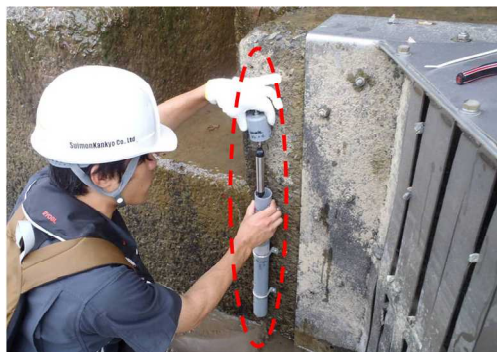
図 5-10 簡易水位計の設置状況
