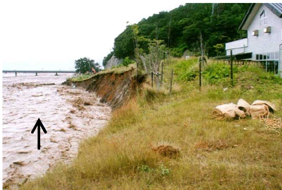
写真 2-32 堤防一部流出状況（糸魚川市大野地先）
