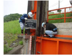
ラック、支持金具等の点検
