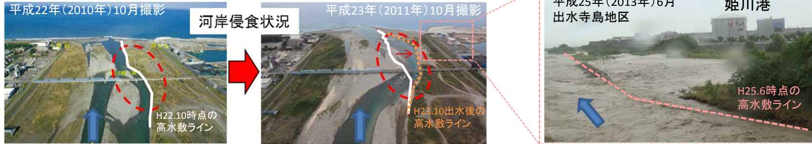
〔寺島地区における河岸侵食状況(図3-2)〕
