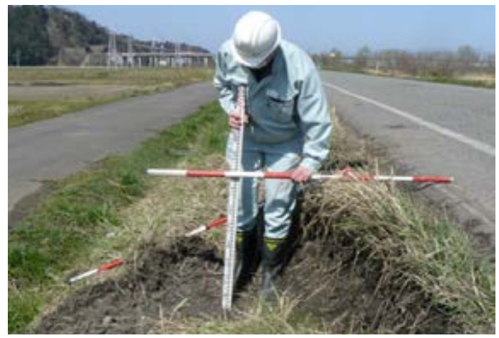
ていぼうてんけん ぎれつ ようす 堤防点検と亀裂の様子
