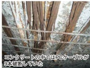
コンクリートの中ではPCケーブルが9本破断していた
