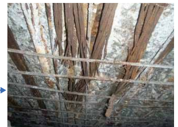
コンクリートの中ではPCケーブルが9本破断していた
