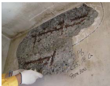
主桁の損傷状況（弁天大橋）
