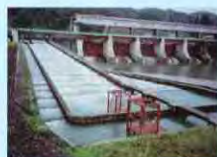
宮中取水ダム魚道トラップ
