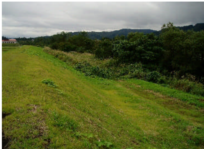
信信信F15 魚沼橋上流 左岸 50.3~51.5km (上流側から下流を望む)
