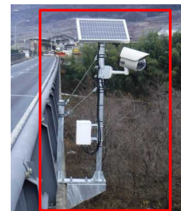
簡易型河川監視カメラの外観 (設置予定の機器)
