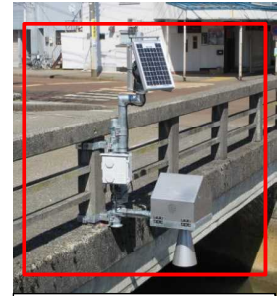
危機管理型水位計の外観 (長岡市殿町・柿川)
