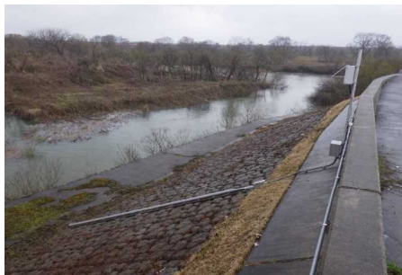
水位計設置状況（長岡市西蔵王）
