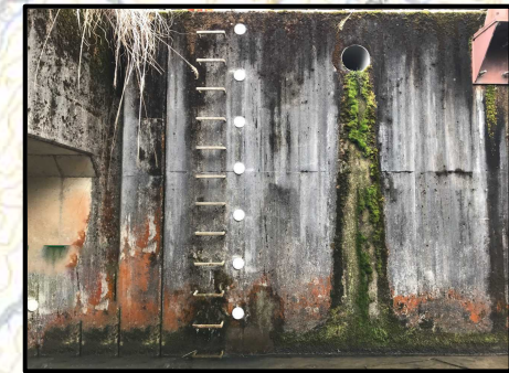
【6】湯殿川救急排水機場
