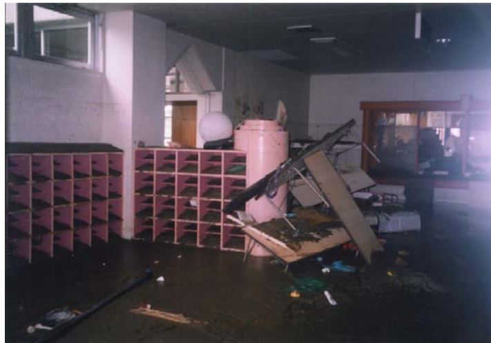
被災後の保育所の中。壁面は濁流の痕跡が確認できる。
