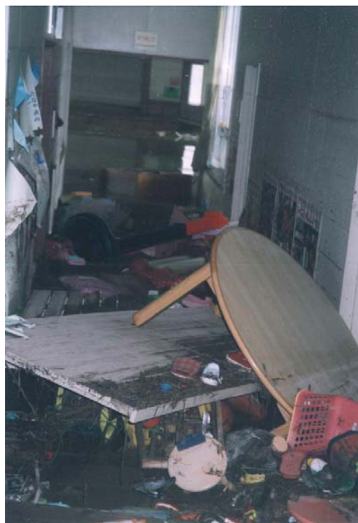
被災後の保育所の中。大量の土砂とゴミが流れ込んだ。
