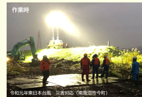
令和元年東日本台風 災害対応 (南魚沼市今町)
