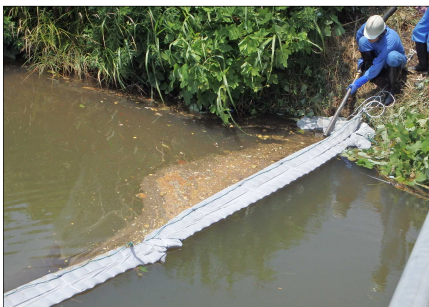
油の回収作業。完全に回収するには時間と費用、手間がかかります
