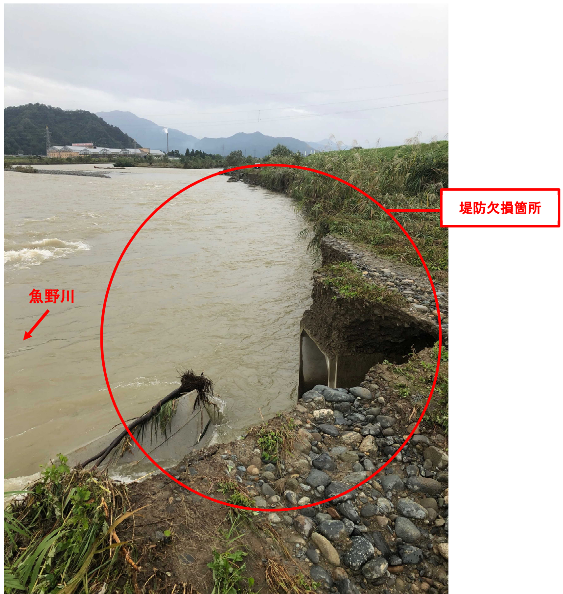
堤防欠損箇所【写 真】
