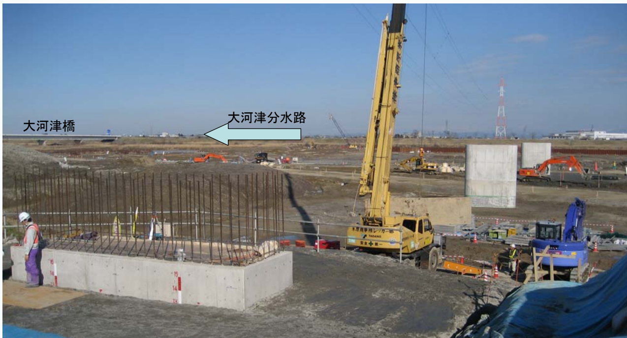
写真上 左岸側堤防から見た現場の状況 (平成19年2月撮影)
