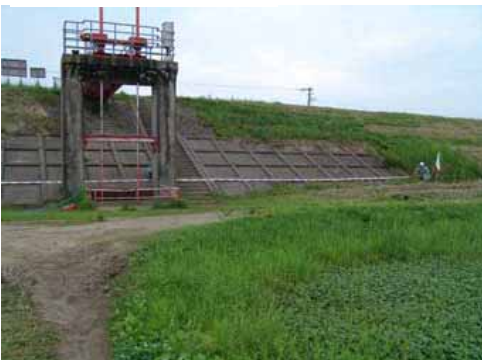
被災した堤防護岸の様子。遠景のためよく分かりませんが、中折れ・沈下等が確認されました。
