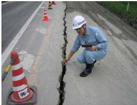
亀裂の状況です。ピンが全て入ってしまうため、亀裂の深さは100cm以上あります。
