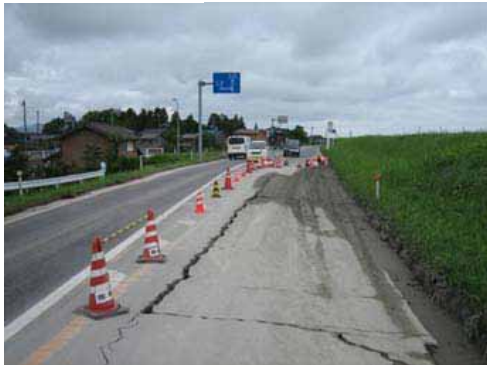
地震直後、堤防居住地側の県道に亀裂が入った様子。
