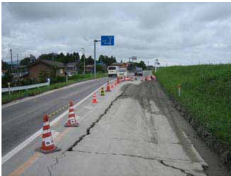
堤防居住地側の県道に亀裂が入った様子。
