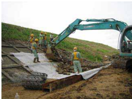
被災した堤防護岸の前面に、「じゃかご」を設置します。じゃかごは、鉄製の網の中に石を詰める応急復旧工法です。
