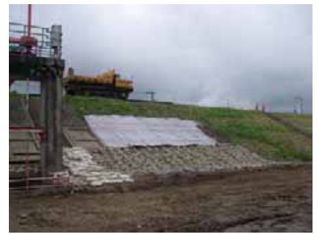
堤防護岸の損傷部へのじゃかご設置を完了しました。引き続き上段部を施工中です。
