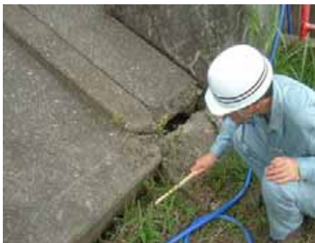
高水護岸の中折れ部分です。沈下により、護岸に開きができています。
