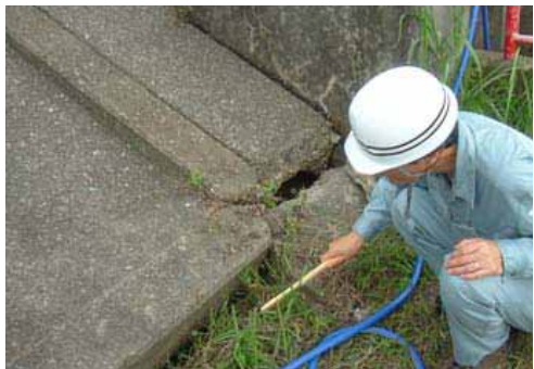
高水護岸の中折れ部分です。沈下により、護岸に開きができています。
