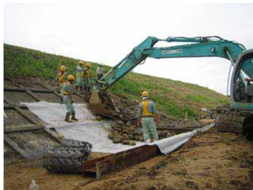
敷き均した後、じゃかご工を行います。じゃかご工は、鉄製の網の中に石を詰める応急復旧工法です。
