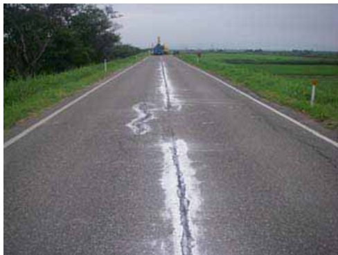
堤防上面に長く亀裂が入っています。(白くなっている部分は、亀裂の深さを確認するための石灰です。)
