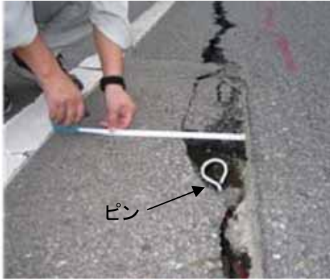
亀裂状況:ピンが全て入ってしまうため、亀裂の深さは100cm以上あります。
