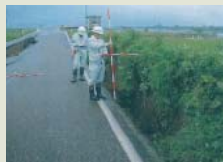
液状化による亀裂や沈下（中之島町長呂地先）
