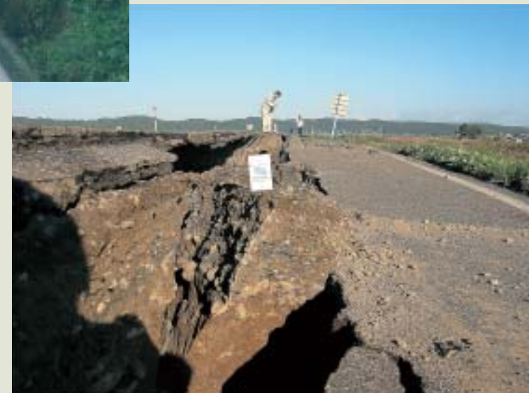
液状化により堤体の亀裂、沈下、法すべりが発生（中之島町長呂地先）
