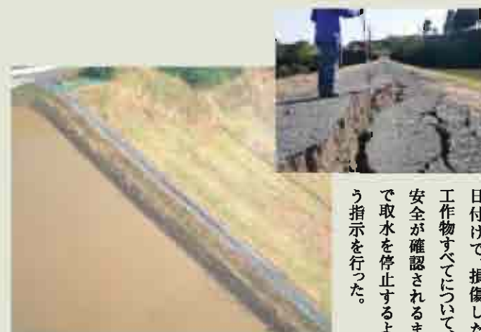
山本調整池天端の被災状況
