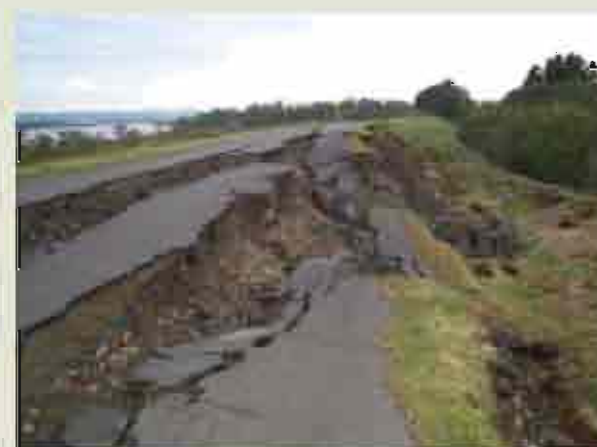
長岡市三俣野地先 大規模崩壊
