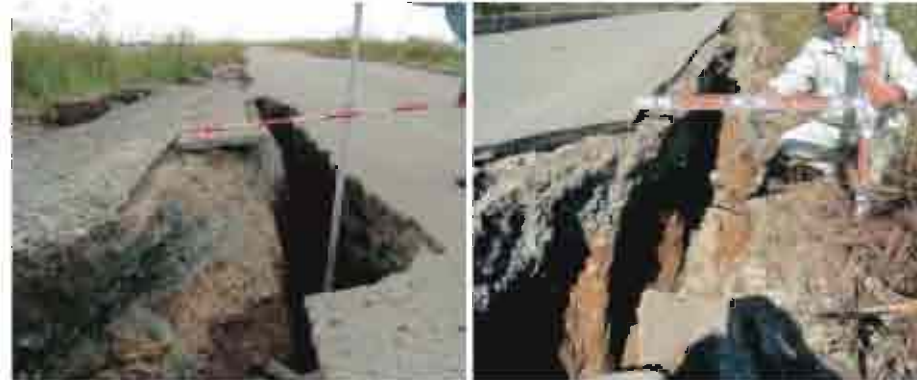
本与板 被災状況
