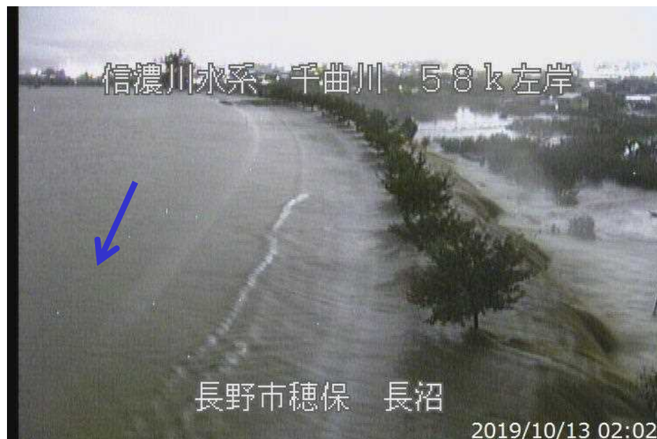
越水状況(10月13日2時頃)
