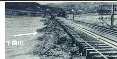
【昭和34年(1959年)8月洪水】信越線ノ井鉄橋での出水状況
