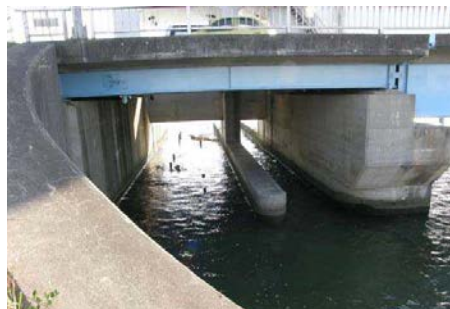
信濃川水門に設置された魚道
