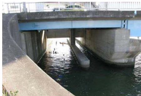
信濃川水門に設置された魚道
