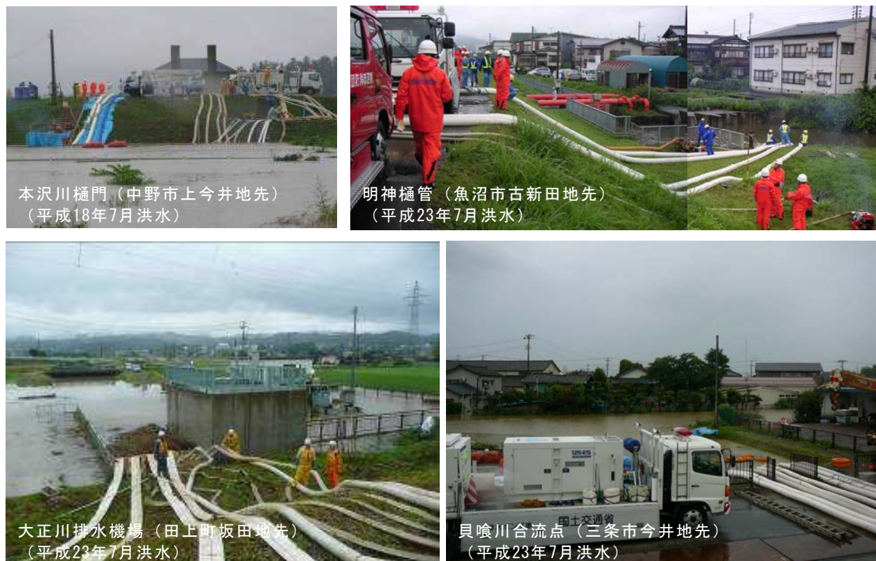
写真 9 内水被害発生と対策の実施状況
