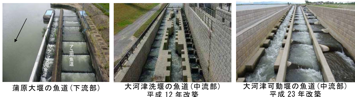
写真 67 魚道の設置事例
