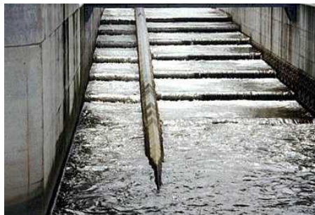
大島頭首工に設置された魚道
