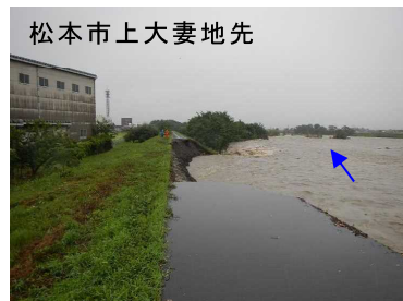
令和3年8月洪水による堤防欠損
