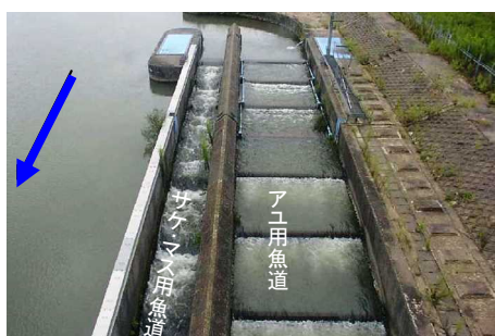
蒲原大堰に設置された魚道
