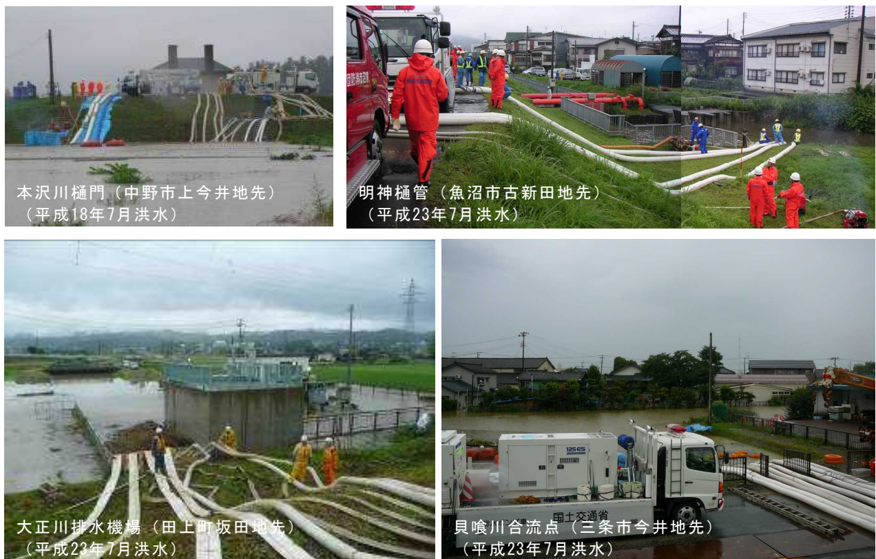
写真 9 内水被害発生と対策の実施状況
