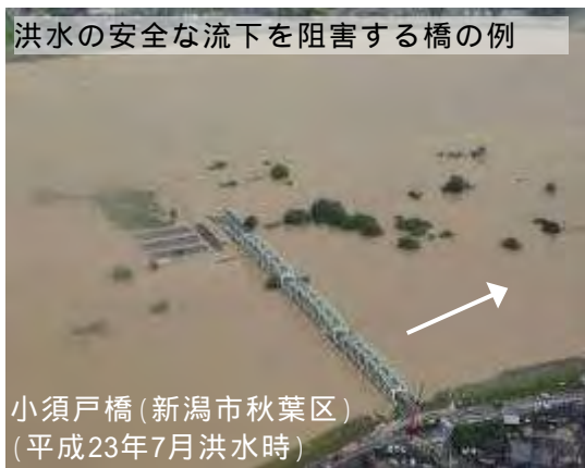
写真 5 改築が必要な横断工作物の例
