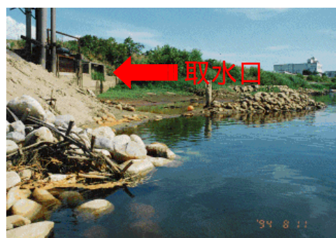
取水口からの取水不能（加茂市）
