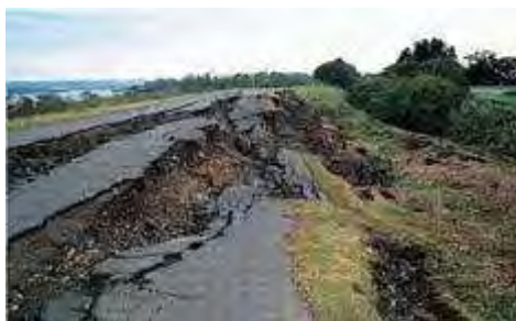
堤防天端の縦断亀裂 (長岡市三俣野)
