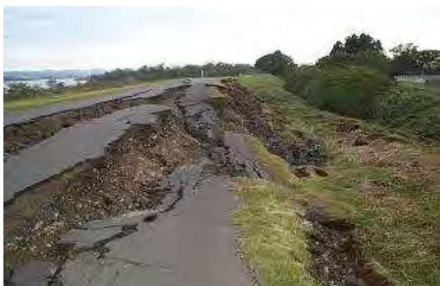
大規模崩壊(長岡市三俣野地先) (平成 16 年 10 月 24 日)
