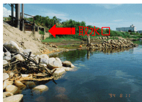
取水口からの取水不能（加茂市）
