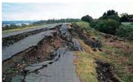
堤防天端の縦断亀裂 (長岡市三俣野)
