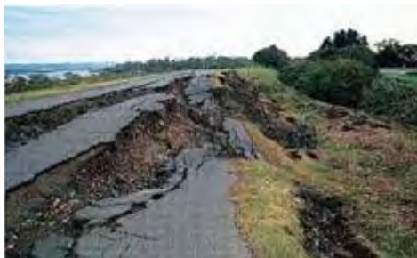
堤防天端の縦断亀裂 (長岡市三俵野)
