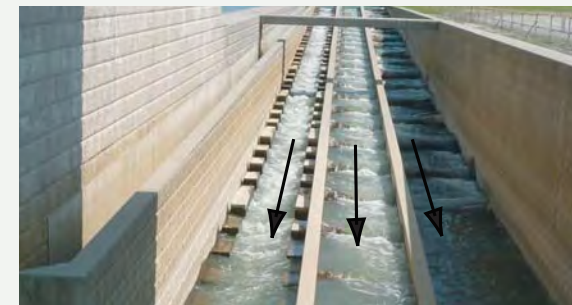
▲大河津新可動堰の魚道（平成23年11月通水）
