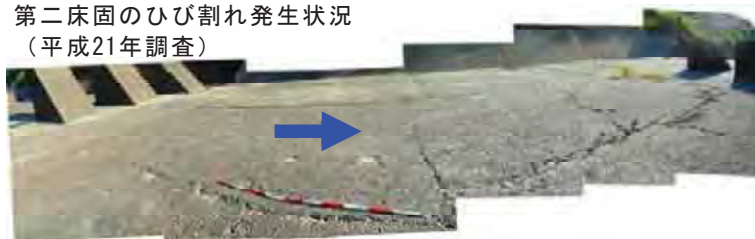
写真 17 大河津分水路 第二床固の老朽化状況
