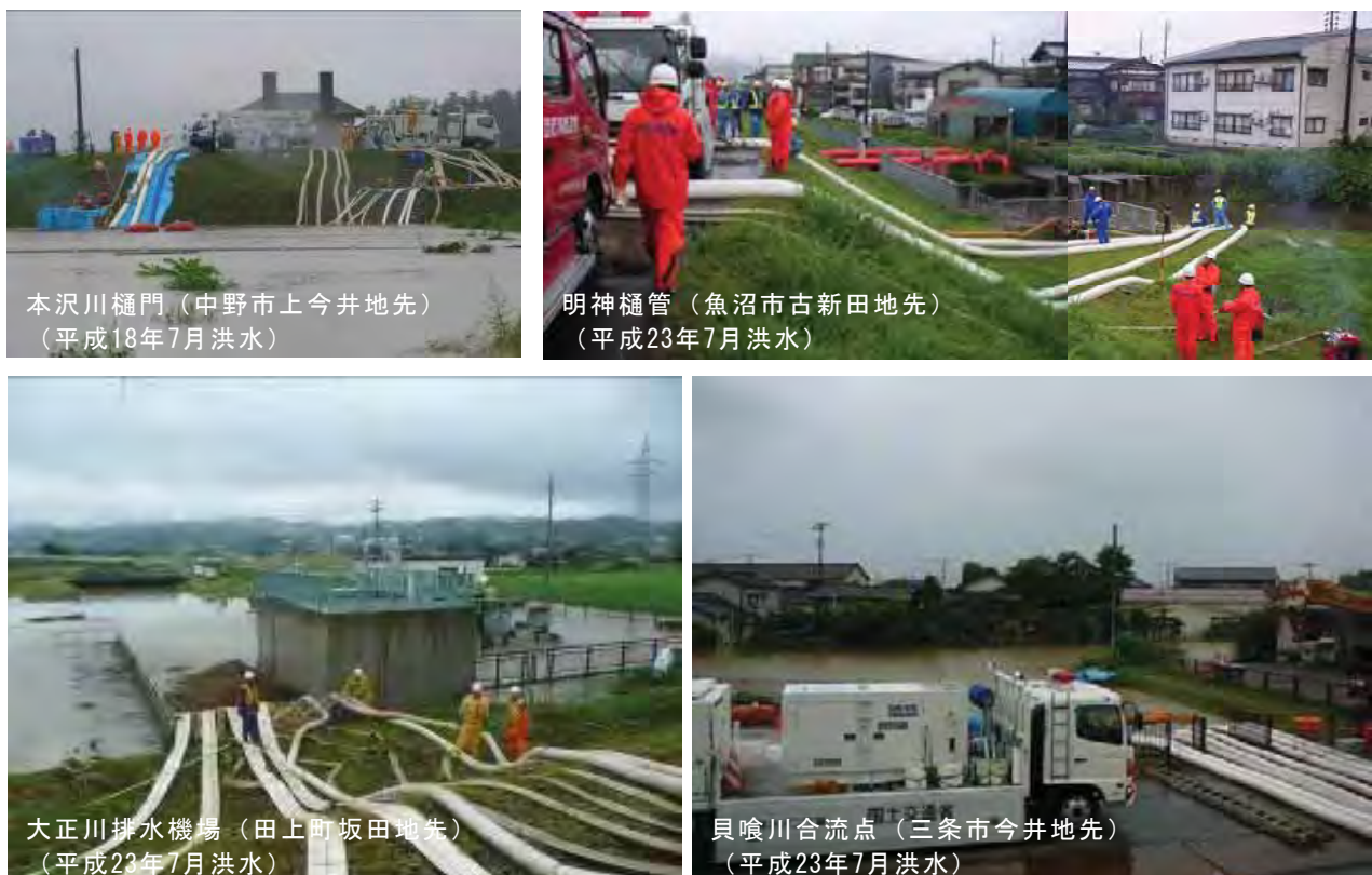
写真 9 内水被害発生と対策の実施状況
