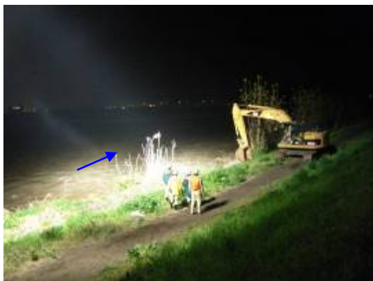
平成 23 年 5 月洪水時の応急対応（長野市綱島地先）
