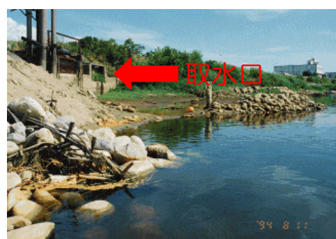
取水口からの取水不能（加茂市）
