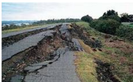
堤防天端の縦断亀裂 (長岡市三俣野)
