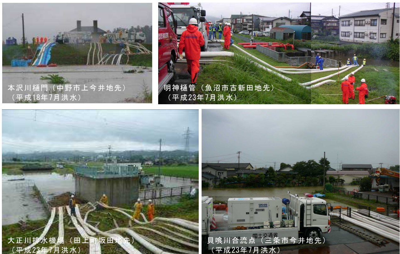
写真 9 内水被害発生と対策の実施状況
