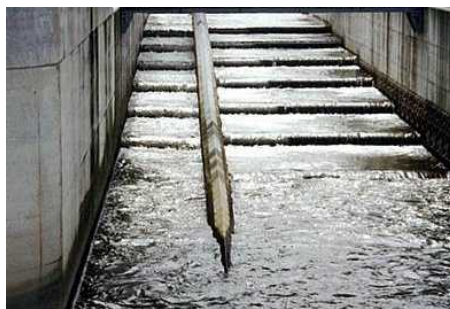
大島頭首工に設置された魚道
