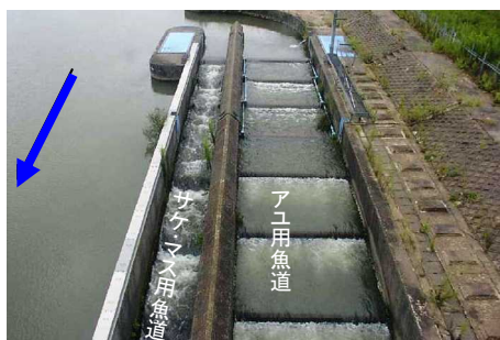
蒲原大堰に設置された魚道
