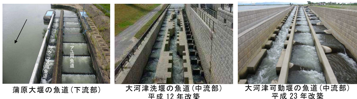
写真 67 魚道の設置事例
