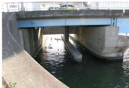
信濃川水門に設置された魚道
