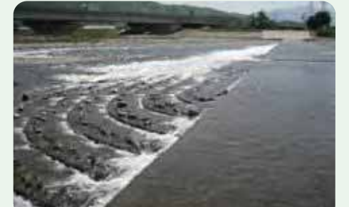
▲勘左衛門堰（犀川）の魚道
