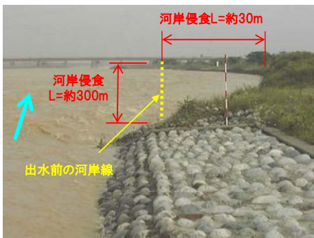
図 5-11 河岸の侵食状況（H11 洪水）
