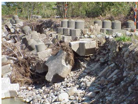
図 5-10 洗掘による被害
