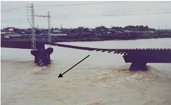
図 5-8 洪水時の洗掘による鉄道橋梁の落橋 （昭和 51 年 9 月洪水 Q_p \approx 2,650 \text{ m}^3/\text{s} ）
